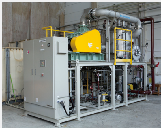
ヒートポンプ式減圧濃縮装置
